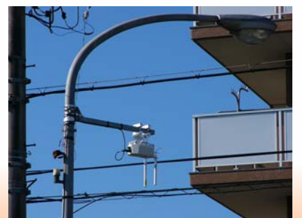
図 3：メッシュ無線 LAN 設置状況
